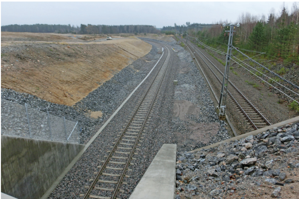
Bild 2: Nybyggt stickspår från Svealandsbanan, som svänger av mot norr, för Eskilstuna Logistikpark, Vy från Ärlavägen, Lv 899, mot öster, Kjulamon, Eskilstuna kommun, 2012-11-10 Foto: Håkan Gustafson
